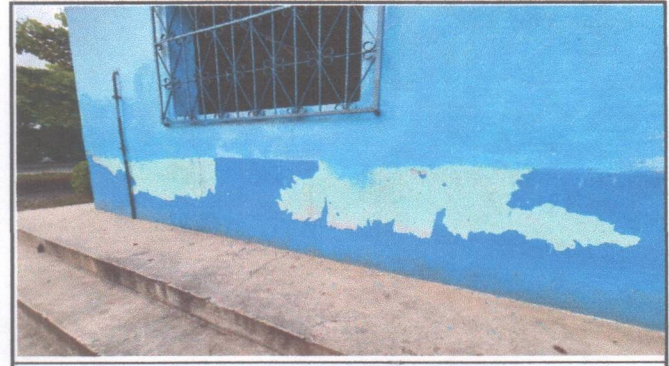
Foto 4: USO DE PINTURA EN AULAS AFECTADAS POR DESPRENDIMIENTO DE CAPA DE PINTURA Y DELAMINACION.
