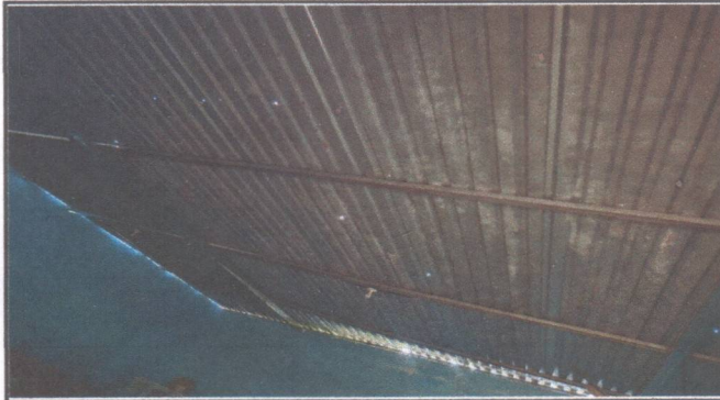
Foto 1: CAMBIO DE ESTRUCTURA METALICA Y LAMINAS POR FISURAS Y GRIETAS, ADEMAS DE OXIDACION Y CORROSION.
